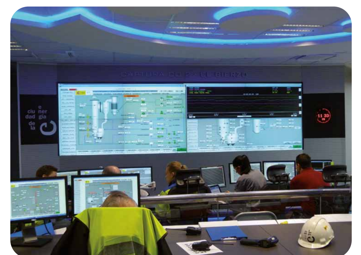
Sala de control
