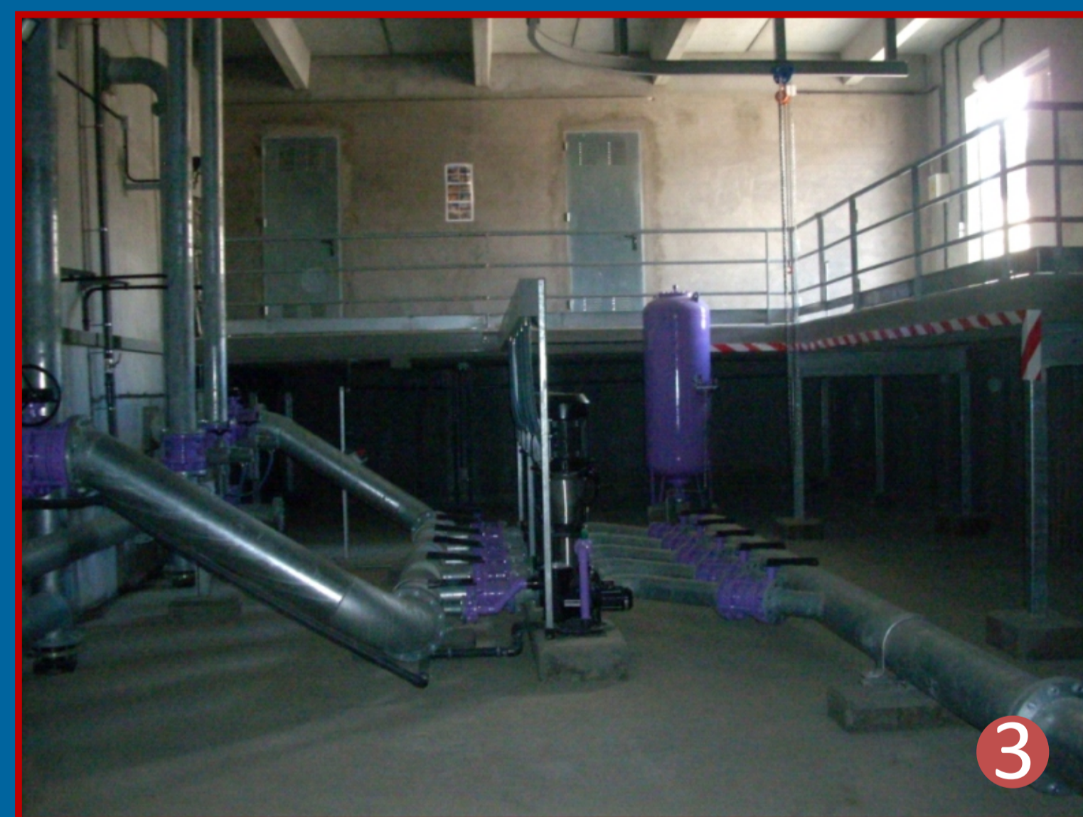
Estación de bombeo red de riego
