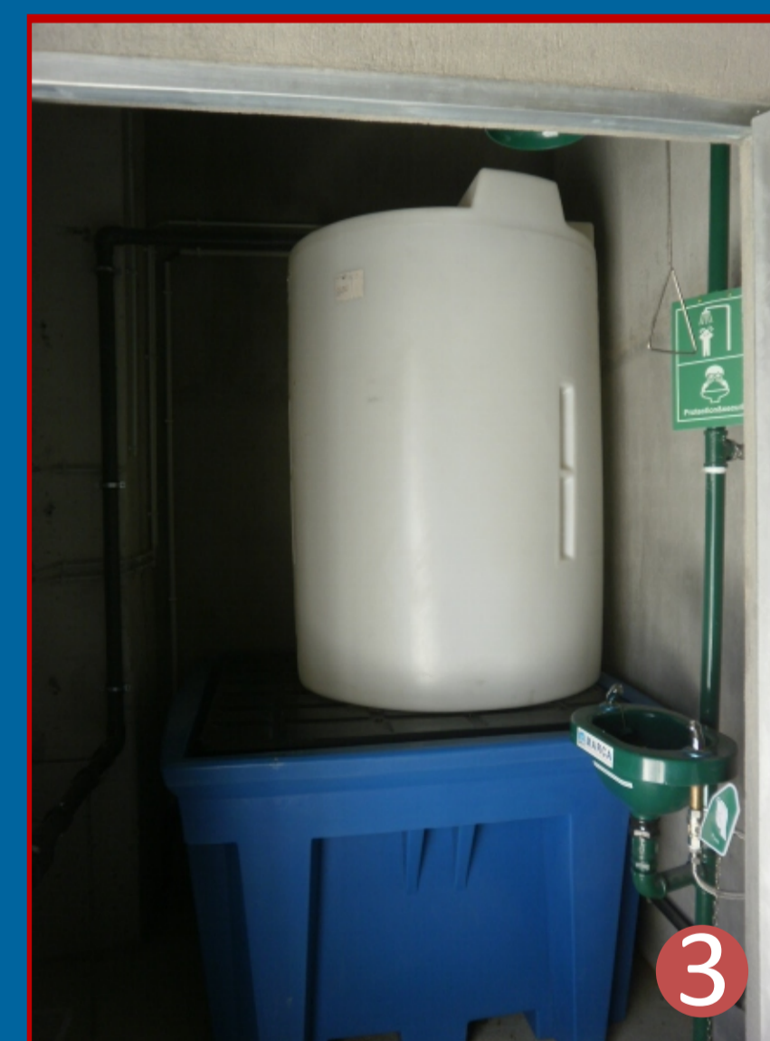
Sala de cloración
