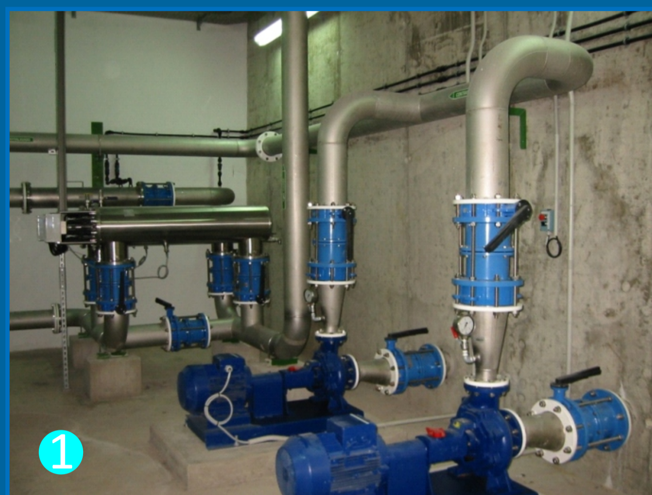
Estación de bombeo terciario-depósito
