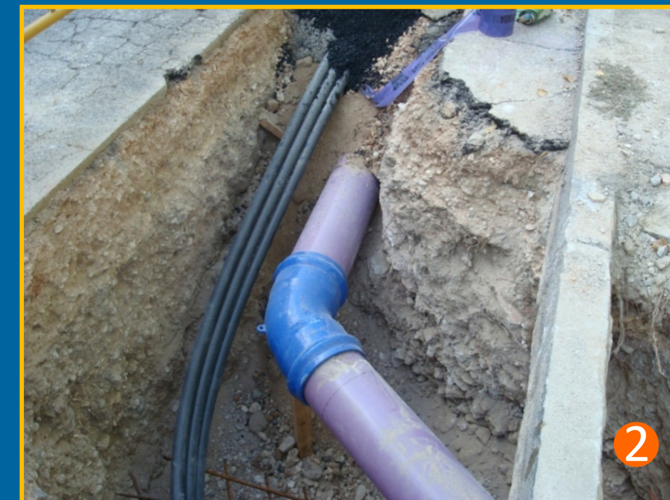
Aducción y tritubo comunicaciones
