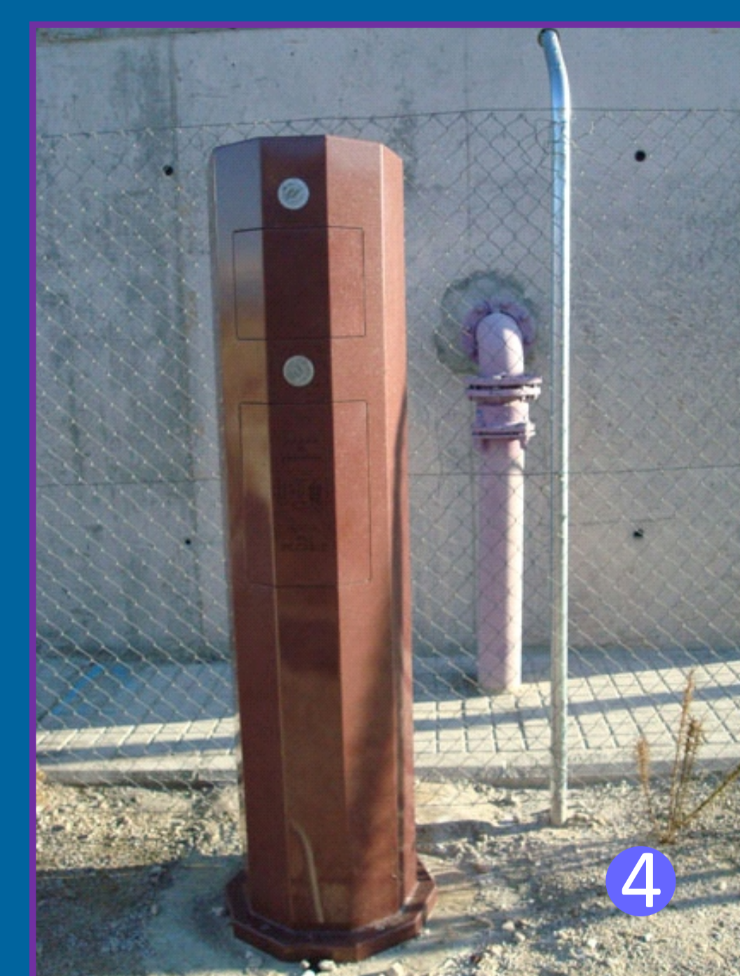
Estación de toma de muestras en red
