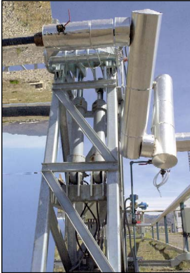
Extremo tubo absorbedor (receptor solar) con partes móviles CCP.
