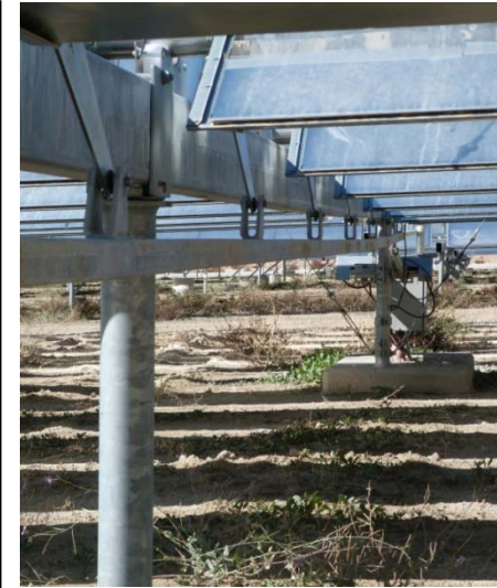
Sistema de seguimiento en Puerto Errado 2 (CLF).
