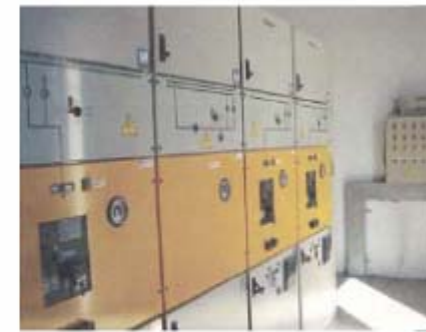
Estación suministro eléctrico
